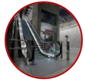
Escaleras mecánicas y ascensores
