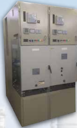
Centros de Distribución de Potencia y CCM en MT o BT
